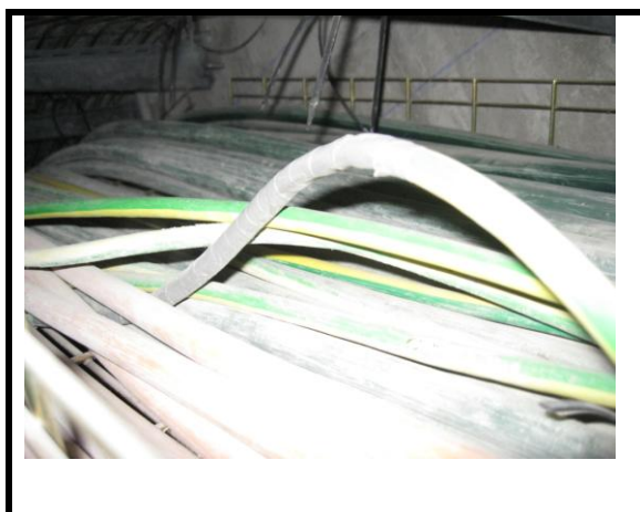
Incidencia 14 Cable de toma de tierra dañado en regiband
