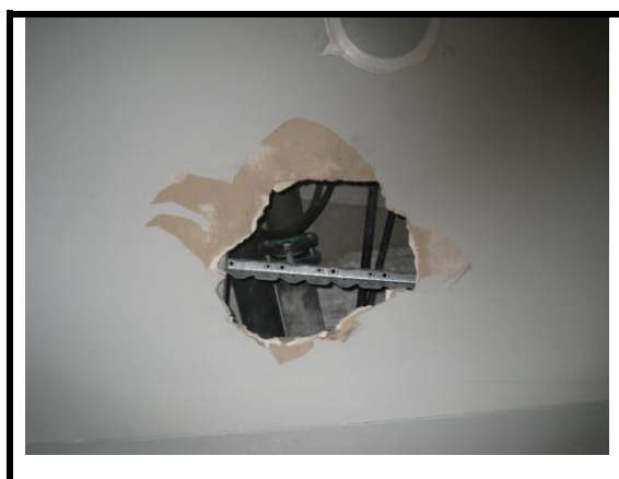
Incidencia 146 Goteras en el techo de los baños
