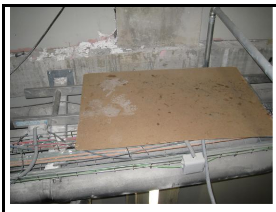
Incidencia 166 y 167 Aún sigue habiendo material de obra y suciedad encima de la regiband
