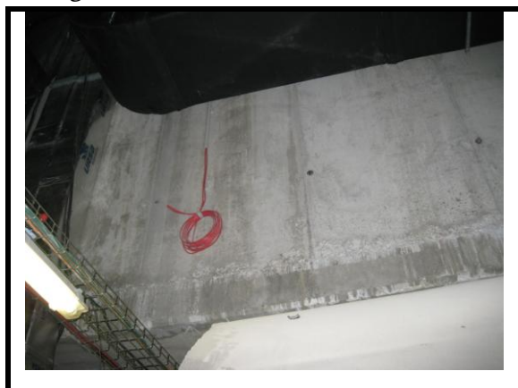
Incidencia 78 Mangueras colgando del techo
