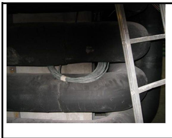
Incidencia 45 Manguera colgando de regiband sin saber qué alimenta
