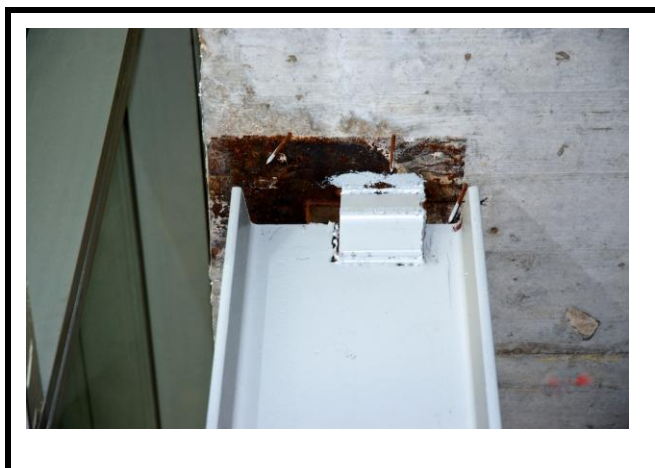
Incidencia 216 y 217 Hall entre sector III y IV. Corrosión en la estructura metálica del techo
