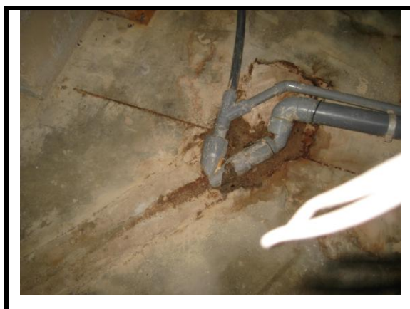
Incidencia 71 Desagüe deficiente
