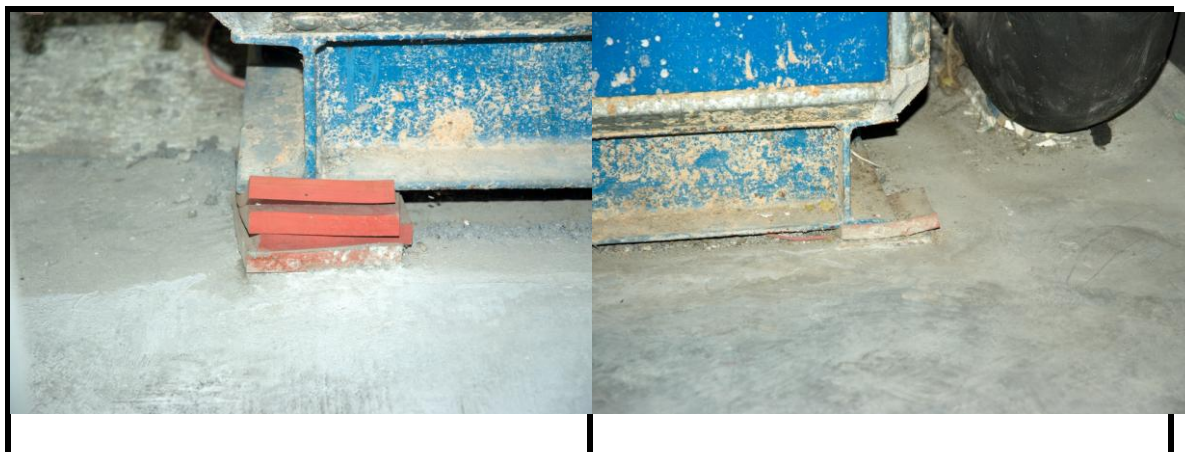
Incidencia 181 Sujeción incorrecta de las UTAs
