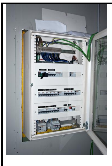
Incidencia 218 Sala técnica sector IV. Hay instalaciones temporales que cuelgan del cuadro eléctrico y no permiten cerrar debidamente la puerta
