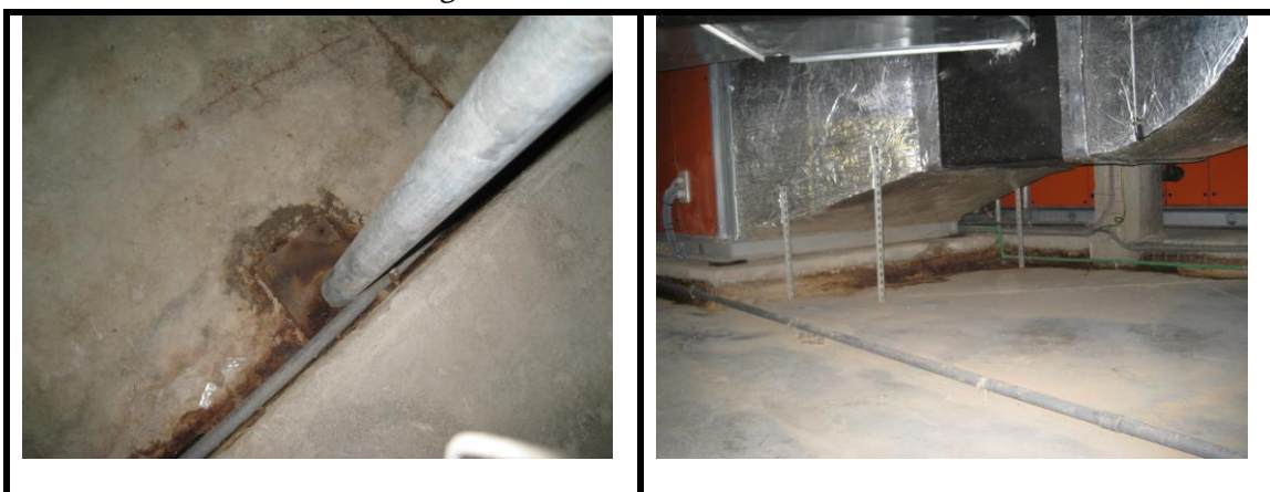
Incidencia 76 y 77 Marcas de oxidación en las soleras de menergas y UTAs debido a las constantes acumulaciones de agua
