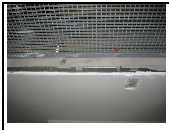
Incidencia 164 Falta remates en el hueco de la ventana de aireación
