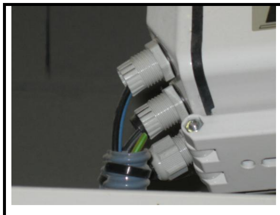
Incidencia 135 Cámara conectada sin toma de tierra
