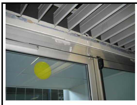
Incidencia 127 Los remates de pladur de las puertas de cristal dobles están sin terminar
