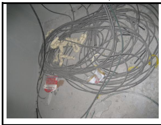
Incidencia 99 Cables mal instalados en el hueco del respiradero del vomitorio
