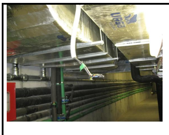
Incidencia 34 Cables colgando en pasillo después de quitar piano en pasillo frente a la sala de UTA-14
