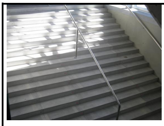
Incidencia 100 En el hall del sector 2 en la escalera al guardarropa hay dos hileras de leds que no se encienden
