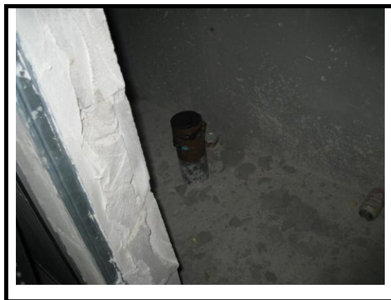
Incidencia 145 Restos de tubo en hueco de aireación
