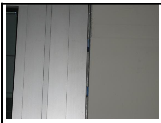
Incidencia 128 y 129 Hay huecos entre puertas y marcos sin rellenar
