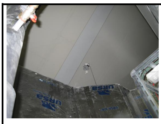
Incidencia 171 Agujero en el techo
