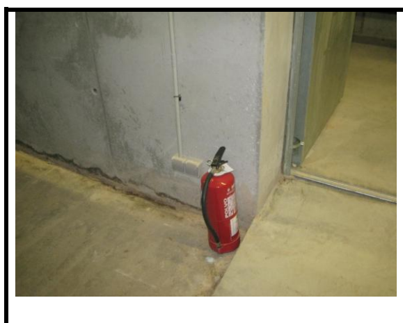
Incidencia 33 Falta colgar extintor en sala UTA 14
