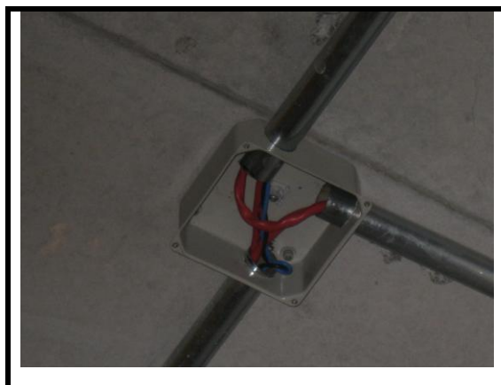
Incidencia 132 Caja de empalmes sin cerrar
