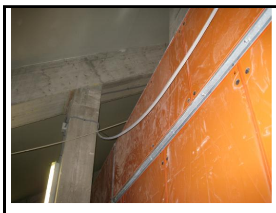
Incidencia 165 Tubo mal instalado
