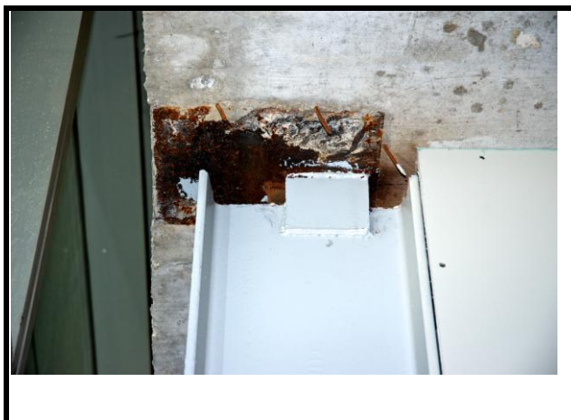
Incidencia 215 Sala técnica sector III. Corrosión en la estructura metálica del techo
