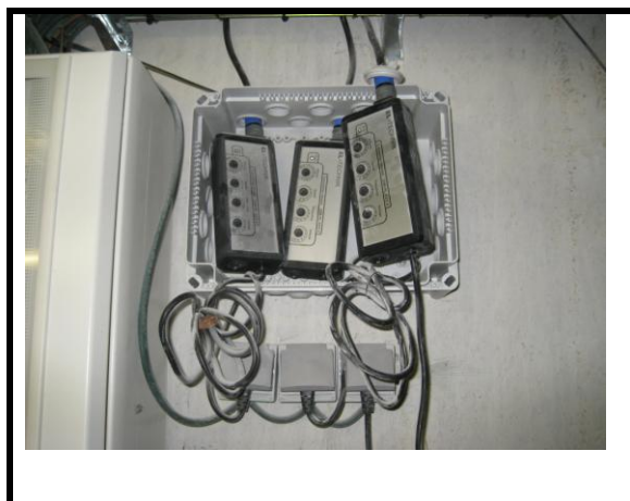
Incidencia 42 Manguera cortada en regiband zona pozos negros
