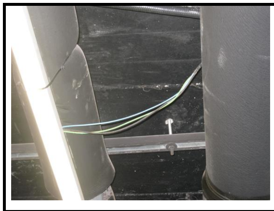
Incidencia 120 Cableado sin protección
