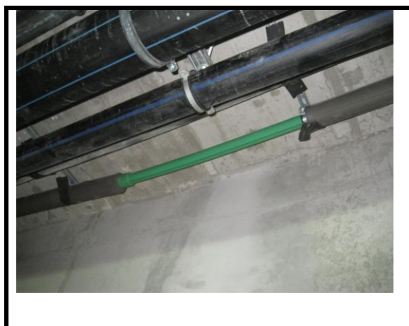
Incidencia 21 Falta aislante en tubería
