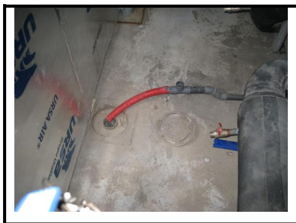
Incidencia 72 Desagüe UTA 11 deficiente
