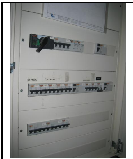
Incidencia 155 Falta marcar térmicos del cuadro del gimnasio
