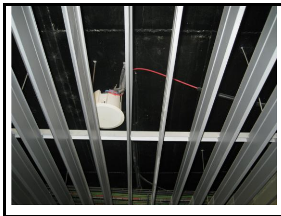
Incidencia 126 Altavoz conectado con cable contra incendios
