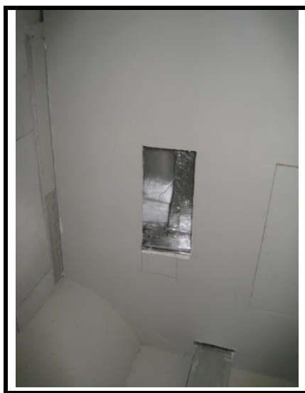
Incidencia 96 Falta rejilla aire acondicionado en el almacén opuesto al acceso a la pista
