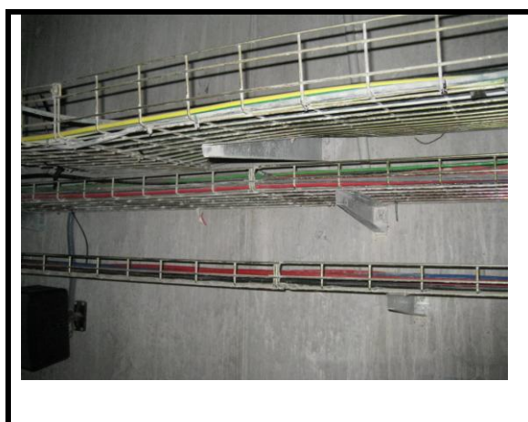
Incidencia9 Soporte regiband desclavado
