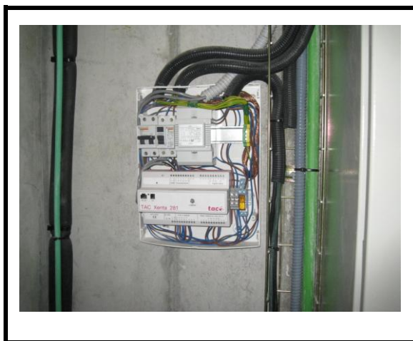
Incidencia 3 Falta tapa del cuadro
