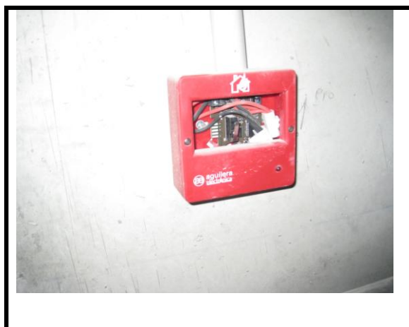
Incidencia 27 Falta tapa pulsador contra incendios
