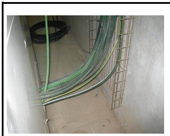
Incidencia 51 Falta trozo de regiband para unir la pared con el cuadro de eventos
