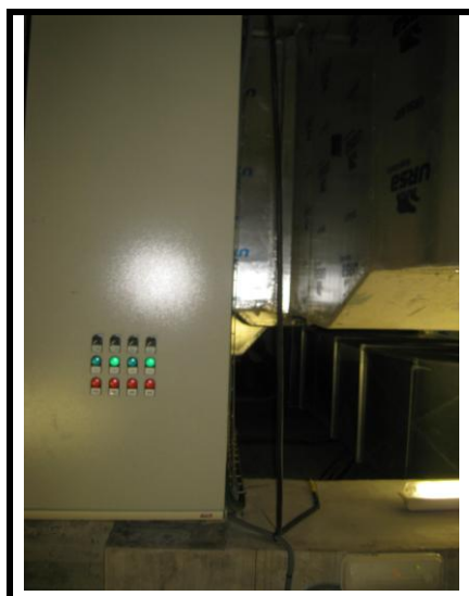
Incidencia 74 Tubo que va al cuadro de las UTAs demasiado corto
