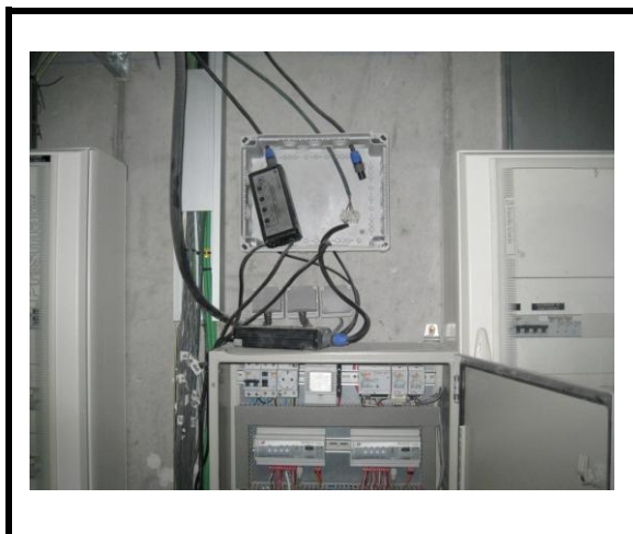
Incidencia 2 Instalación en mal estado. Falta un módulo convertidor.
