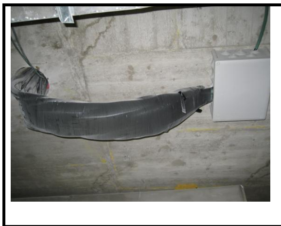
Incidencia 44 Cables colgando del techo sin regiband
