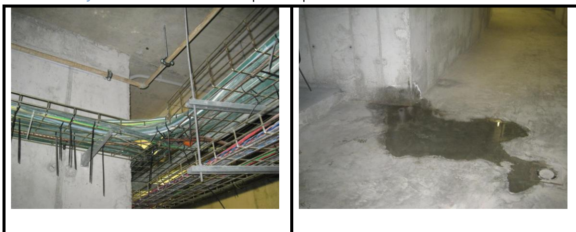
Incidencia 19y 20 Codo de tubería con pérdida permanente
