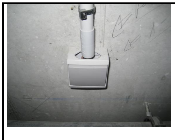
Incidencia 40 Interruptor sin goma en sala contra incendios
