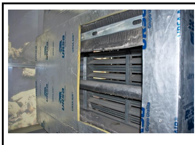
Incidencia 182 y 183 Los conductos de las máquinas de aire acondicionado de la cota 50 no disponen de entrada de aire exterior. Los conductos presentan aberturas.
