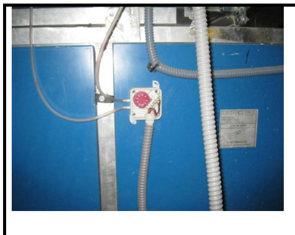
Incidencia 32 Falta tapa de interruptor diferencial potencial UTA 14
