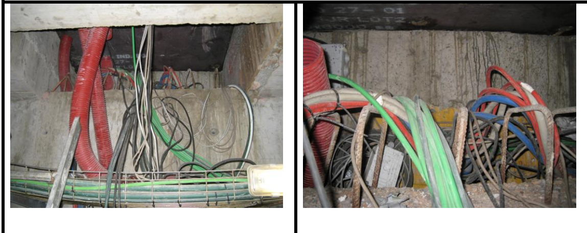
Incidencia 49 y 50 Instalación incorrecta
