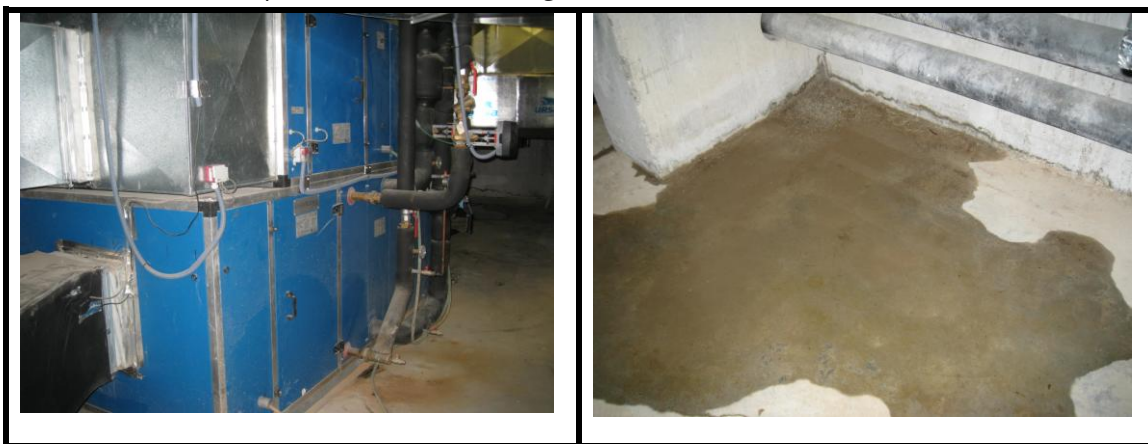
Incidencia 75 El recuperador carece de desagüe
