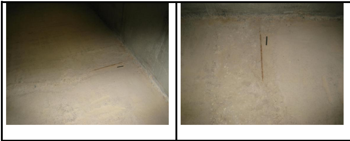
Incidencia 54 y 55 El suelo no es uniforme y se ven las varillas del encofrado
