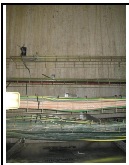
Incidencia 11 Regiband mal acabada. Falta altavoz
