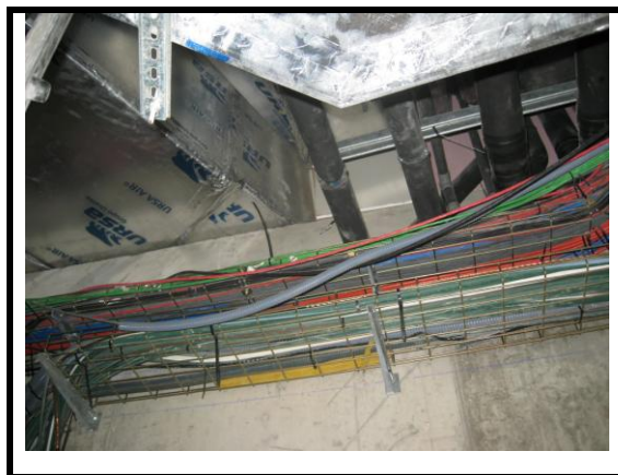
Incidencia 170 Cableado y entubado mal instalado
