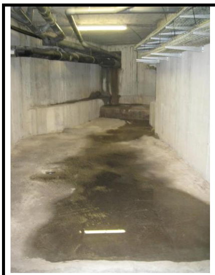
Incidencia 16 Tubo sin desembocar. Pierde agua continuamente
