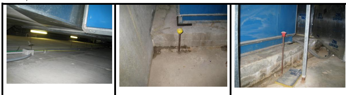
Incidencia 73 Varillas sin cortar (Se sugiere prueba de equipontenciabilidad de la toma de tierra)
